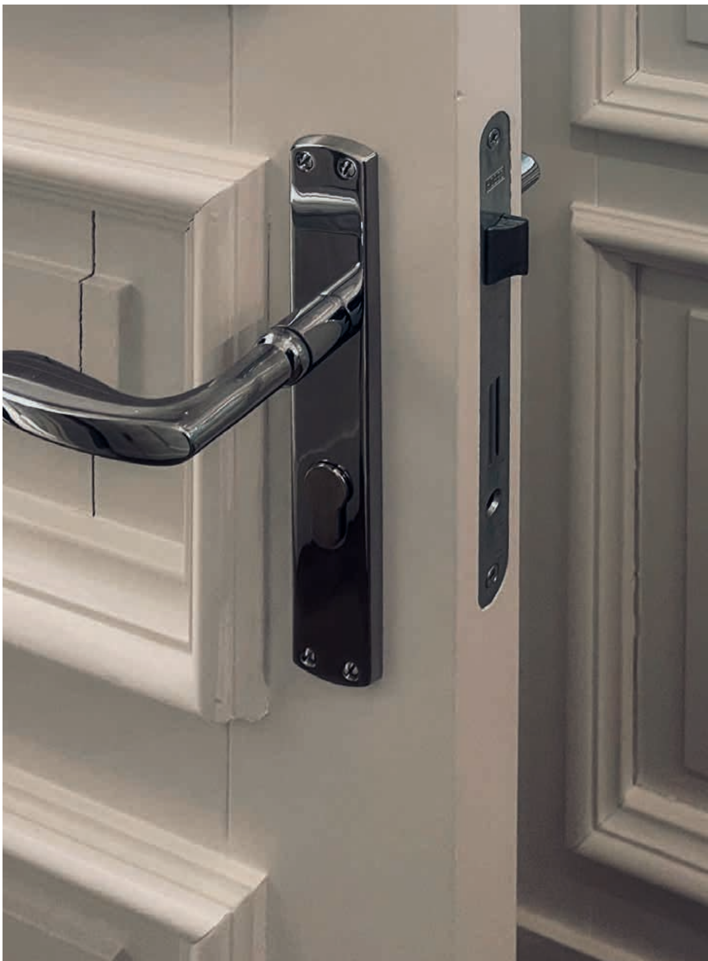
Nedostatečně vysušený materiál pro výrobu interiérových dveří. Materiál kazety byl před výrobou vlhký, po povrchové úpravě a instalaci v interiéru dřevo začalo sesychat
