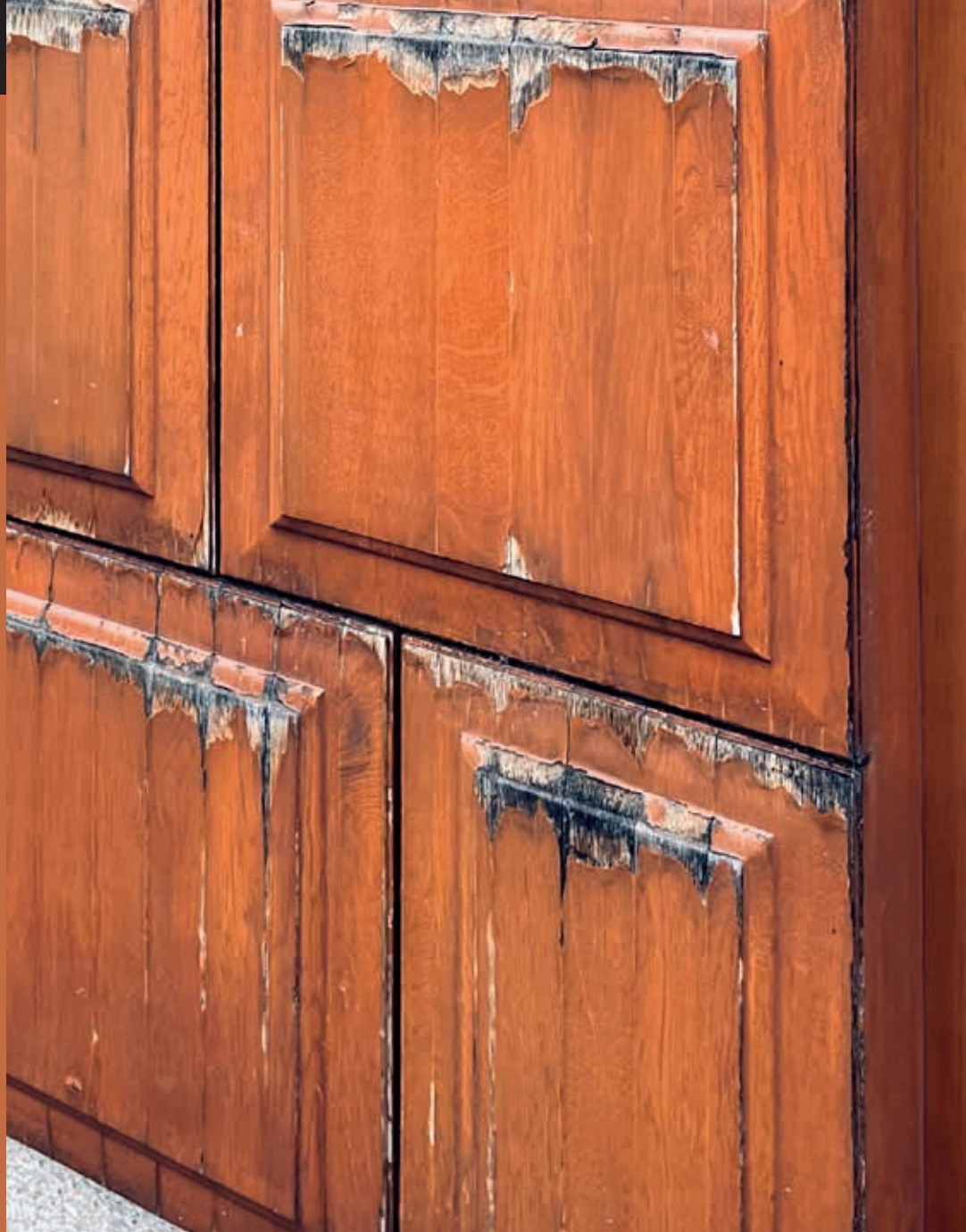
Nevhodně použitý materiál pro výrobu obložení prodejny – truhlářská spárovka, určená pro interiérové aplikace degradovaná abiotickým vlivem
