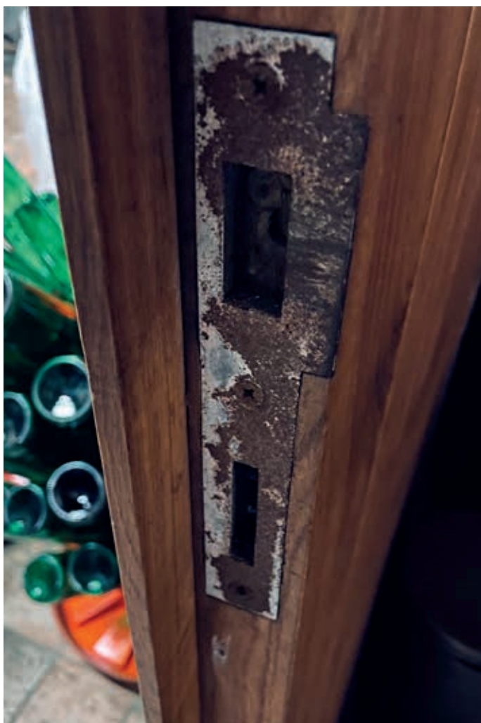
Na snímku je koroze kování dubových dveří ve vinném sklípku po 10 letech provozu
